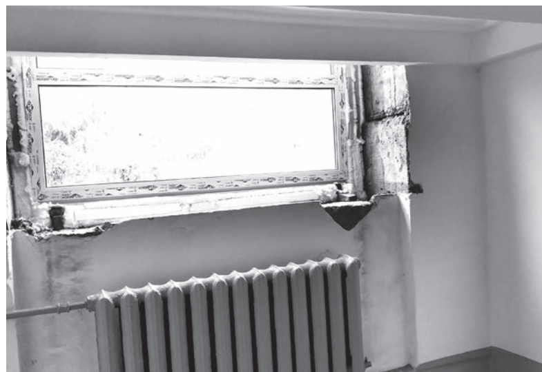
Окна в подъезде заменили, уже почти месяц прошёл, а подрядчик до сих пор не отделал откосы и подоконники
