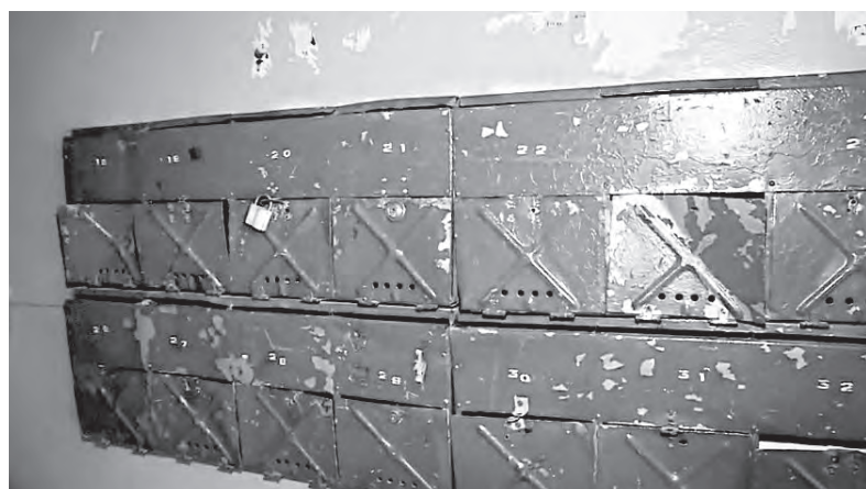
В тарифе на обслуживание жилья в некоторых домах текущий ремонт не заложен. С каких денег красить и шпаклевать, не совсем понятно
