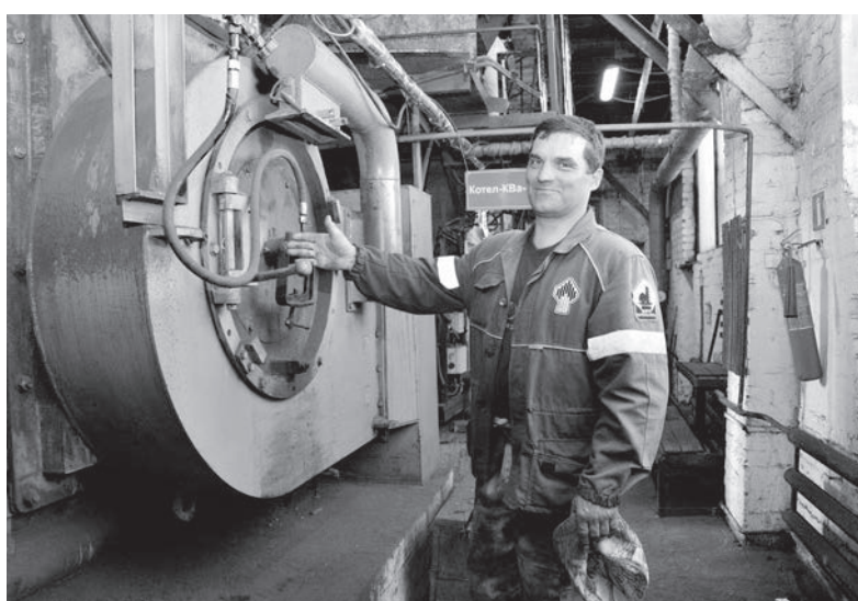
Александр ЗЫКОВ работает в котельной Савватеевки без малого 16 лет, пройдя путь от оператора до начальника котельной
