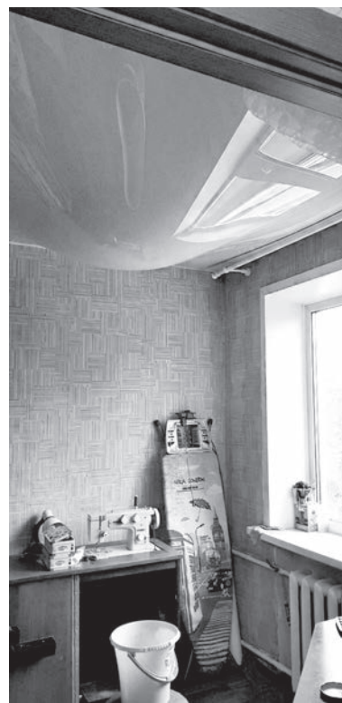
В доме, где идёт капремонт, хозяйка заплатила за спуск воды с подвешного потолка 5 500 рублей
