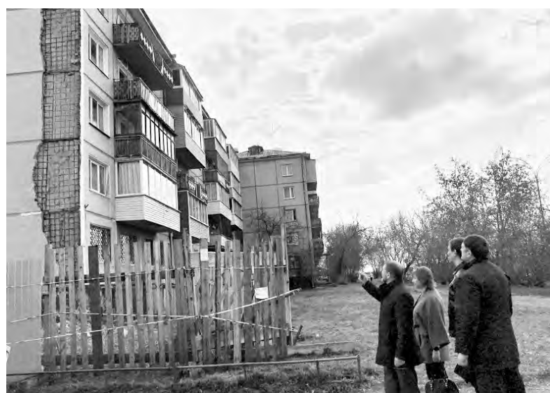
После обрушения части фактурного слоя было принято решение произвести контролируемое обрушение остальной части треснувшей облицовки. Далее будут организованы гидроизоляционные работы, чтобы предотвратить попадание влаги
