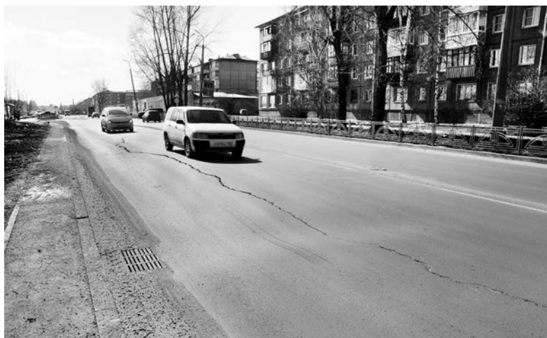
Подрядная организация, допустившая ошибку при капремонте улицы Декабристов, устраним выявленные дефекты до 1 июня. Администрация проконтролирует, чтобы на сей раз всё было сделано качественно
