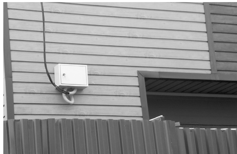
В СНТ «Расцвет», где садоводы установили собственный трансформатор, ведётся строгий учёт электроэнергии и все счётчики установлены в зоне видимости
